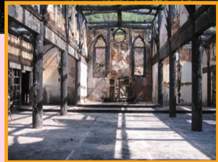
焼失した 江袋教会の内部▶
